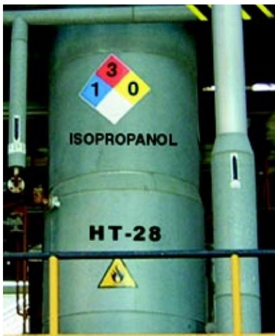
Figura 8 Tanque señalizado según diamante NFPA 704 y señal panel de inflamable
