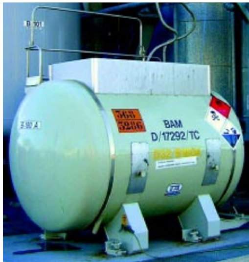
Figura 3 Cisterna móvil con panel y etiquetas de identificación de sustancia peligrosa según ADR.
