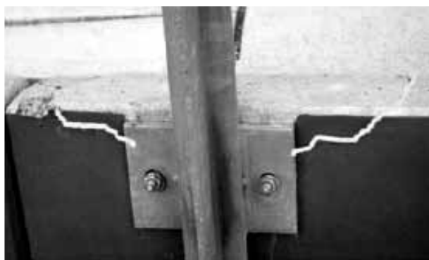
Figura 6. Rotura de anclaje. Anclaje no adecuado al esfuerzo por efecto palanca
