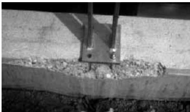
Figura 5. Rotura de anclaje. Distancia mínima al margen de hormigón no respetada o par de apriete excesivo
