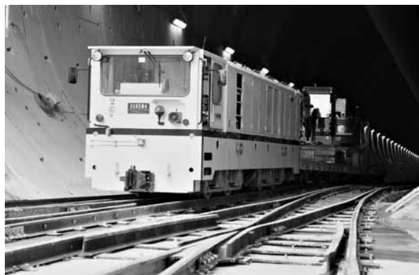
Figura 3. Sistema ferroviario de un túnel para transporte de personal y material al frente de excavación
