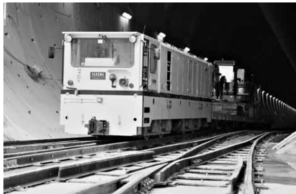
Figura 3. Sistema ferroviario de un túnel para transporte de personal y material al frente de excavación
