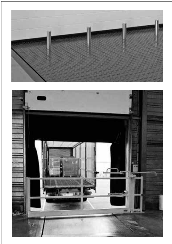
Figura 30. Rampa con bulones extraídos y barrera metálica
