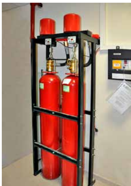
Figura 1. Recipientes de almacenamiento de gas para la protección de archivo
