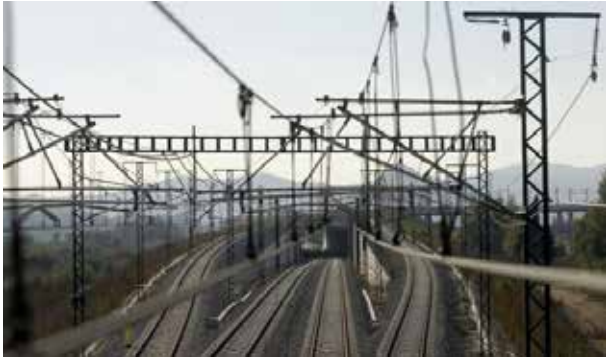
Figura 2. Línea aérea de contacto en vía AVE.
