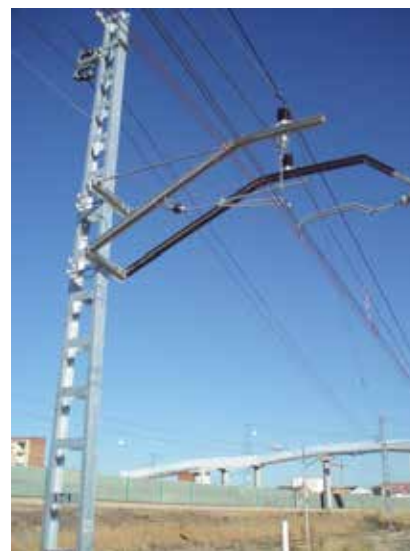
Figura 1. Línea aérea de contacto en vía convencional.
