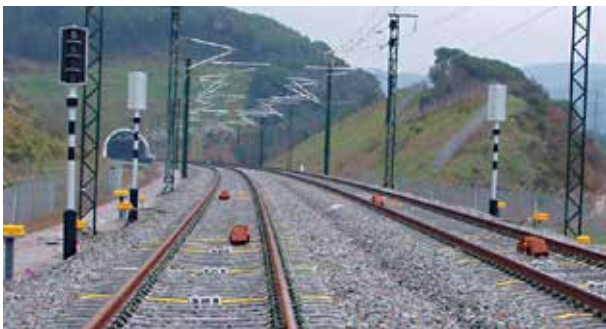
Figura 3. Instalaciones de señalización y de comunicaciones ferroviarias.
