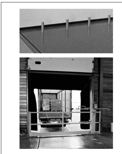
Figura 33. Rampa con bulones extraídos y barrera metálica.
