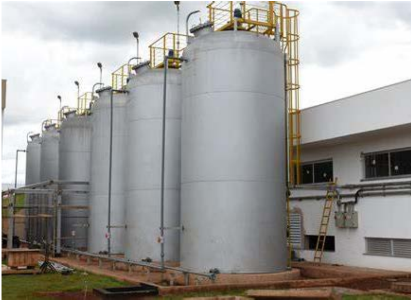
4.1 RECIPIENTES FIJOS = TANQUES
