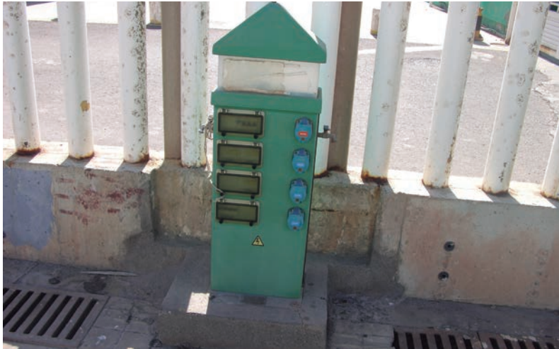
Toma de corriente de la zona de reparaciones
