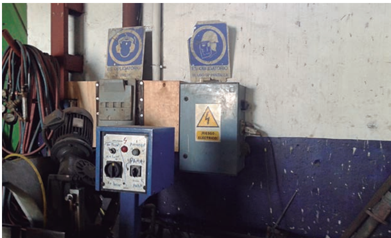
Estado de señalización de un taller
